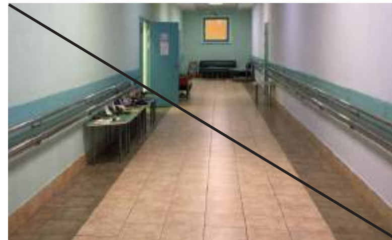
Плохо Керамогранитная плитка с крупными швами
